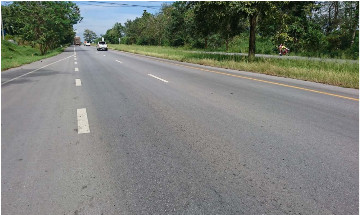
ภาพที่ 3.4 รูปภายหลังจากบูรณะทางหลวงหมายเลข 344 ตอน อ.บ้านบึง – อ.แกลง กม. 56+ 000 RT
